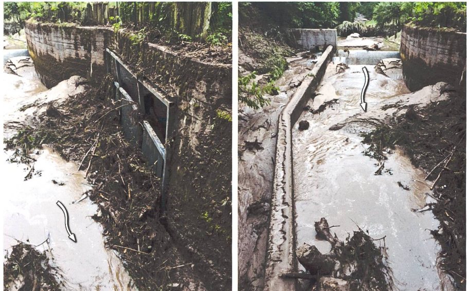
Bild 3. Links: Rechenverklausung beim Einlauf in den Stollen. Rechts: Auflandungen im Verzweigungsbauwerk (mod. nach oeko-b Fotodokumentation, 2015).
