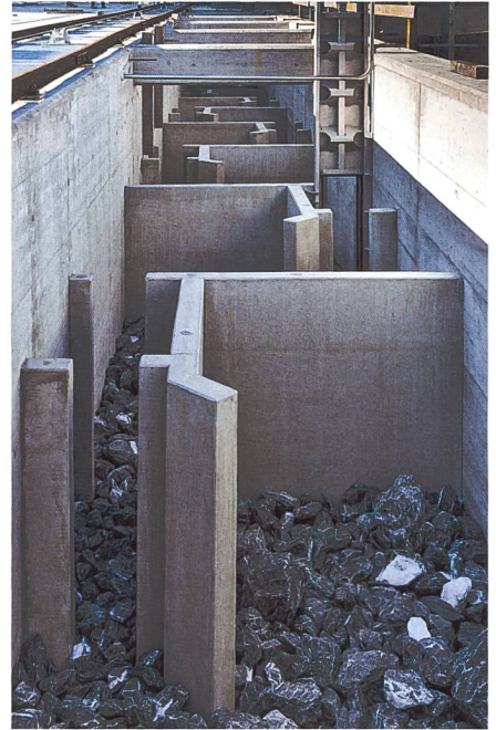
Eine der beiden Fischaufstiegsanlagen am KW Dietikon (Foto: EKZ).
