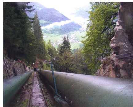
Druckleitung Balbalera, Steilstrecke mit Blick ins Puschlav (Foto: Repower).
