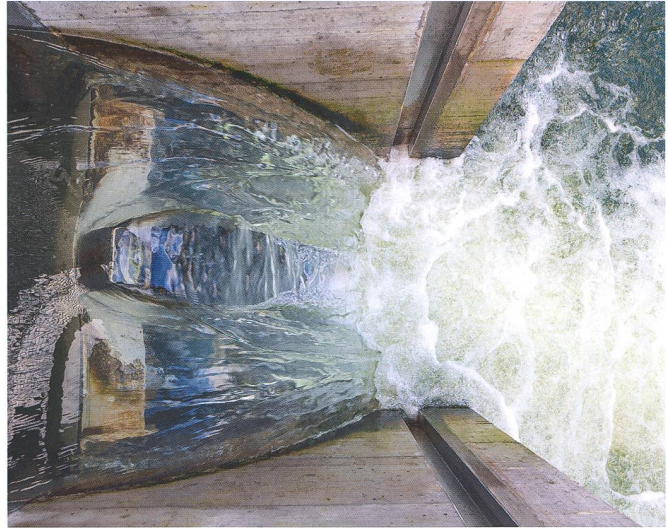
Bild 9: Bypassauslauf ins Unterwasser mit überströmter Stauklappe (Foto: EKZ).
