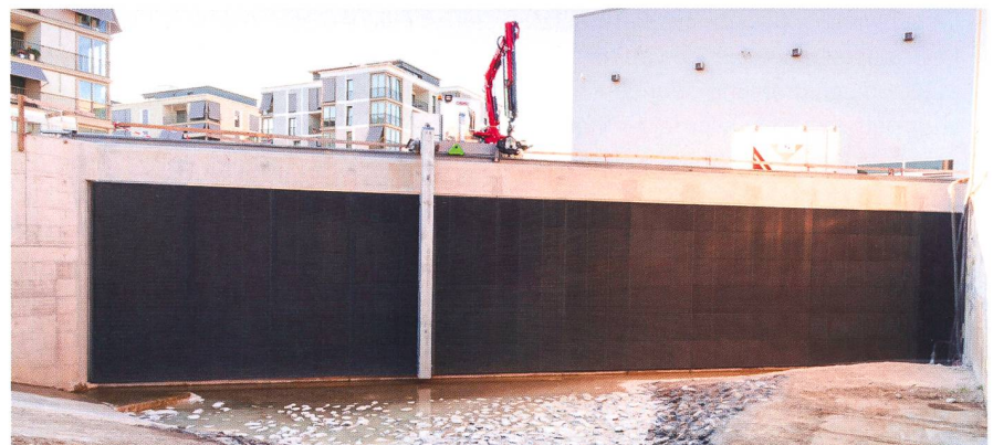
Bild 6: Horizontalreechen HKW vor der Kanalflutung (Foto: EKZ).
