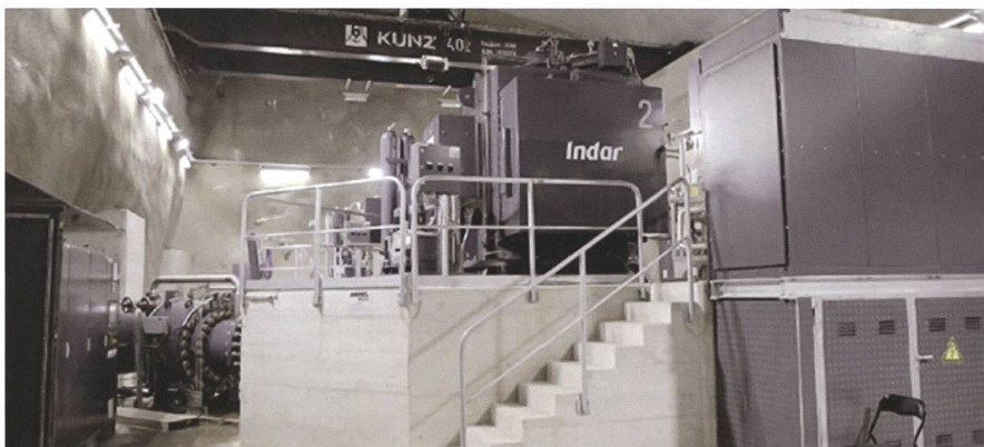
Bild 1: Maschinenraum des Kleinwasserkraftwerks in Oberwald: Die Turbinen mit 2 x 7,5 MW Leistung sind auf die Maximalproduktion im Sommer ausgelegt. Zum Vergleich: Die fünf Windräder, die im Herbst 2020 auf dem Gotthard in Betrieb genommen wurden, haben eine Nennleistung von 5 x 2,35 MW. Foto: FMV.
