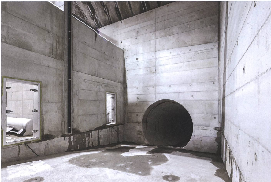
Bild 3: Blick in die Druckaufbaukammer: Rechts hinten beginnt der Druckstollen, durch den das Wasser zum Kraftwerk gelangt. Die Durchgänge links führen ins Entsanderbecken (Foto aus der Bauzeit). Im Entsanderbecken lagern sich die Sedimente ab, die die Rhone vor allem im Frühjahr in grossen Mengen heranträgt. Foto: FMV.
