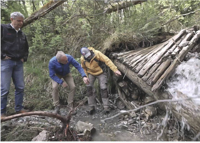
Andreas Stettler besichtigt mit Bernhard Perren und René Lauper die beschädigten Wildbachverbauungen im Meierisli-Graben. Foto: SWV.
