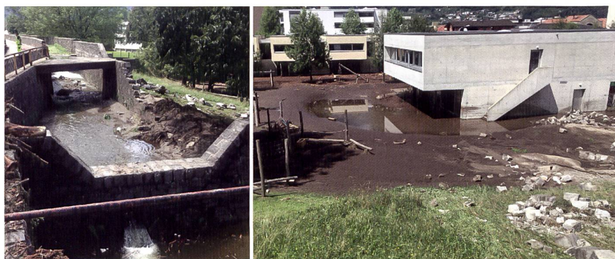
Bild 9: In Giubiasco (Gemeinde Bellinzona TI) führte am 7. August 2021 das Versagen einer seitlichen Mauer des Rückhaltebeckens des Riale Fossato (links) zur grossräumigen Überschwemmung eines Schulareals (rechts) (Foto: Ufficio dei corsi d'acqua, Dipartimento del territorio, TI).
