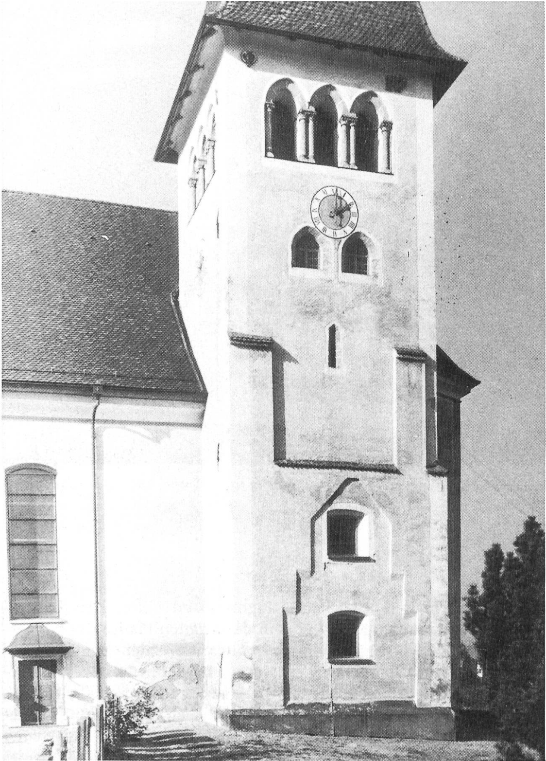
Der baufällige Turm samt einer Kirchenpartie vor der Restauration. Die Turmuhr wurde entfernt.
