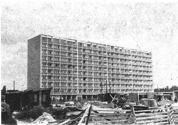
Zehngeschossiges Wohnhaus der Architekten Fritz Jaenecke und Sten Samuelson (Malmö-Schweden).
