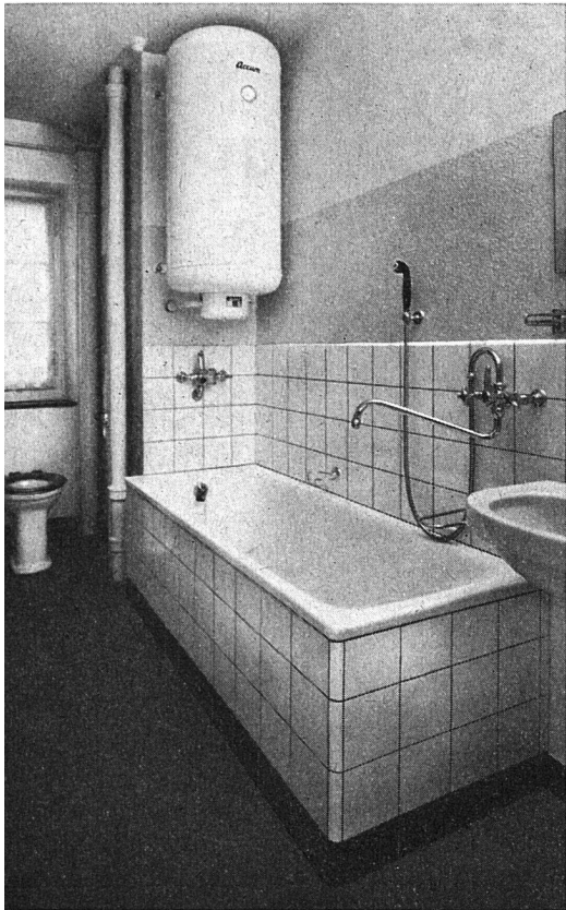
Die Badzimmer erhielten eingebaute Stahlbadwannen, Lavabos mit Zubehör und einen 100-Liter-Elektroboiler, der auch das Warmwasser für die Küche liefert. Ein Teil der Badzimmer erhielt die sogenannte Asig-Batterie, die für Wanne und Lavabo dient. Dadurch konnte die Vergrößerung des Wasserstranges umgangen werden.
