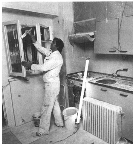
Bei schon bestehender Doppelverglasung kann sich die Renovation oft auf Malerarbeiten beschränken.
