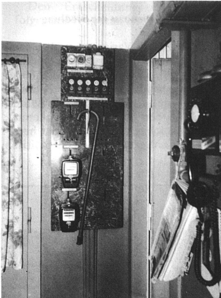
Die Elektroinstallationen sind nicht mehr vorschriftsgemäss.
