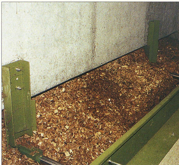
Arbeitserleichterung am «Sonnenberg»: Wenigstens muss niemand Holzschnitzel schippen, sie werden hydraulisch nachgeschoben.
