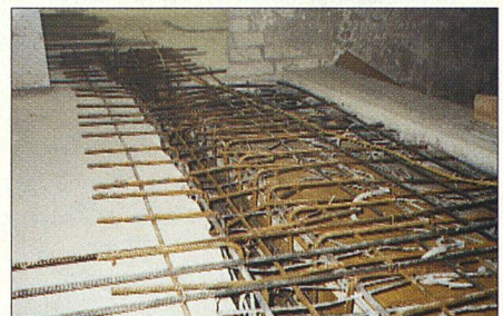
An dieser Stelle war die Betondecke nicht mehr zu gebrauchen. Die Schlämme des alten Holzzement-Unterlagsbodens schieden Salpetersäure aus, welche die Armierungseisen angegriffen hat.
