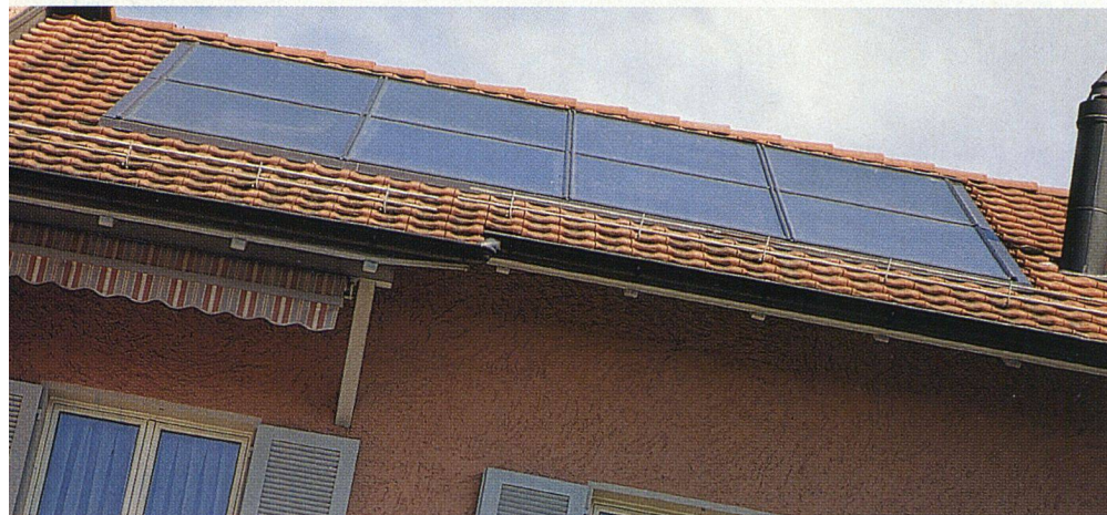
Die Solaranlage auf dem Dach der Liegenschaft Römerweg in Effretikon hilft beim Heizen und liefert Energie fürs Warmwasser.
