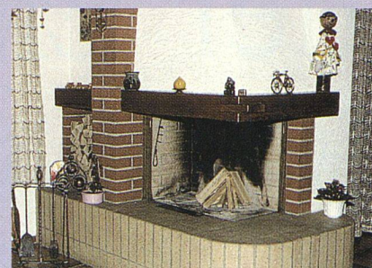
Unverglaste Cheminéés sollten saniert werden.
