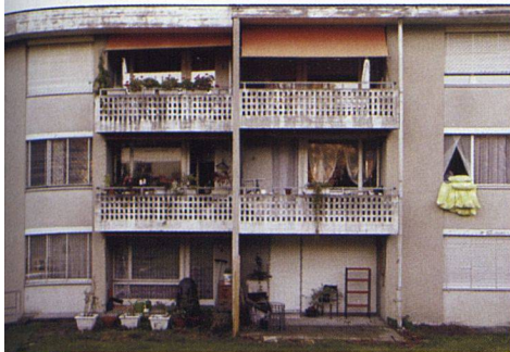
Die rund vierzigjährige Liegenschaft Tösstalstrasse 286/288 vor dem Umbau: desolater Zustand.
