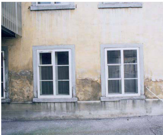
Feuchteschäden im Aussenbereich.
