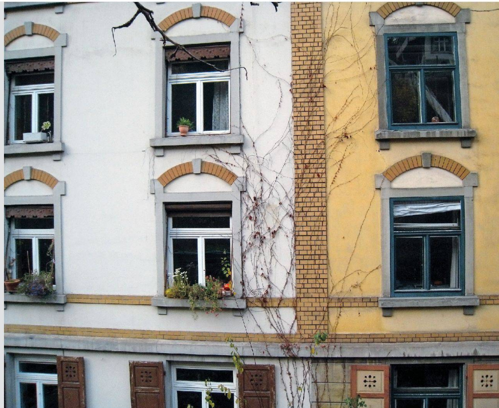
Hohe Qualität: Die Fassaden des Hauses rechts mussten in hundert Jahren nie renoviert werden. Das weiss gestrichene Nachbarhaus wurde dagegen in den 1980er-Jahren nicht sachgemäss renoviert – prompt zeigen sich Putz- und Farbschäden (vgl. Detailbild links aussen).
