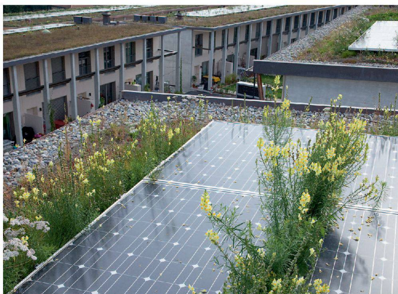
Strom für hundert Haushalte liefert die 3500 Quadratmeter grosse Anlage.
