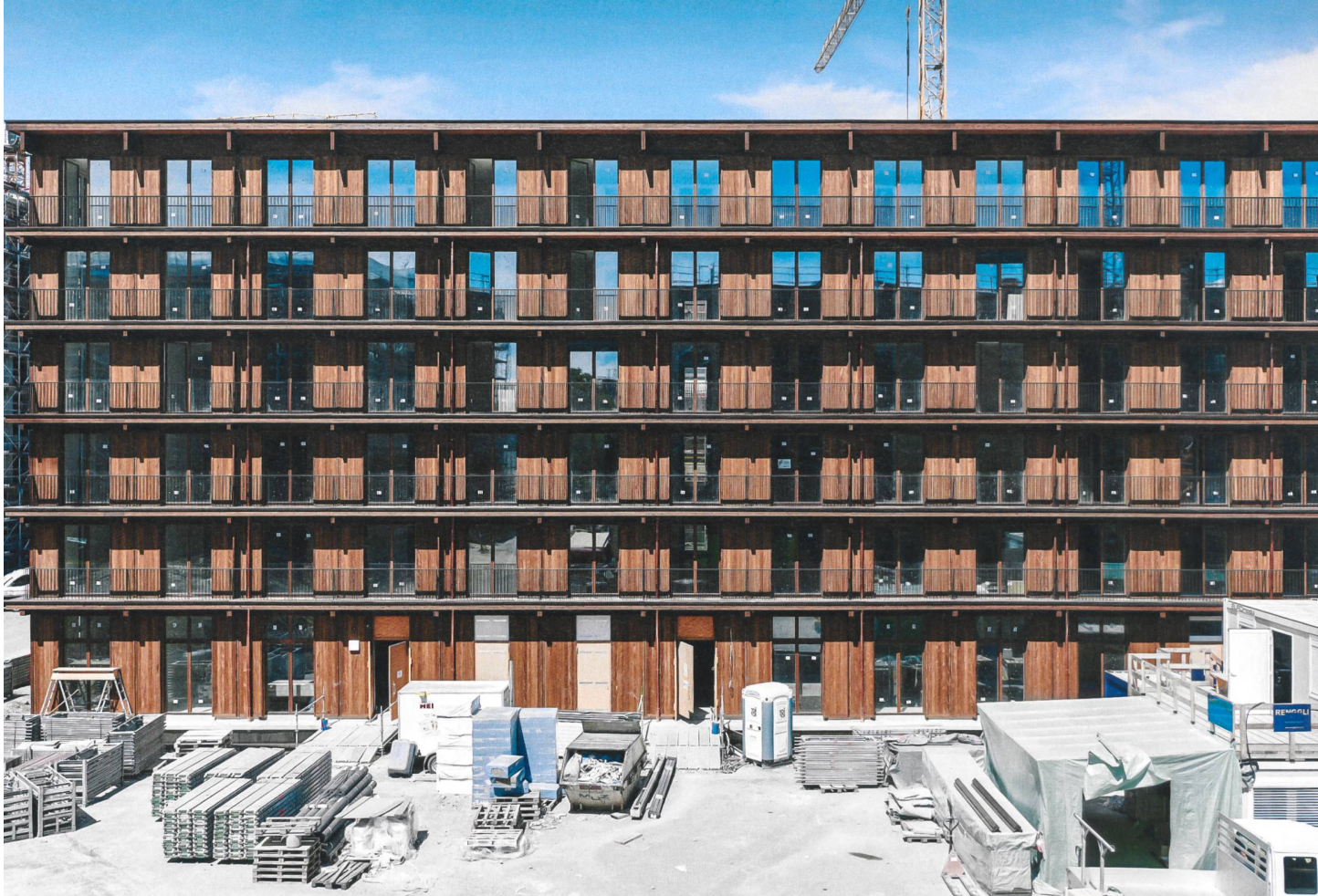
Auf dem Areal des einstigen Zollfreilagers in Zürich Albisrieden hat die Renggli AG drei Holzbauten mit rund 300 Wohnungen errichtet. Die drei Langhäuser bestehen fast vollständig aus Holz, nur das Untergeschoss und die schlanken Erschliessungskerne sind aus Beton.
