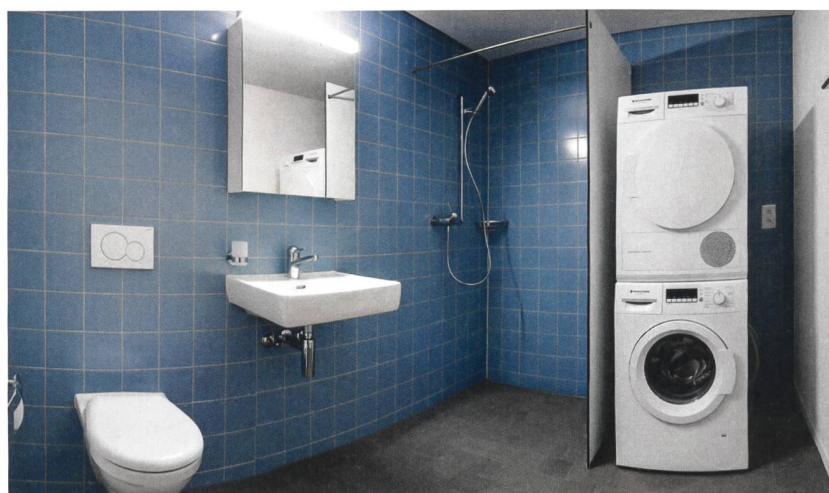
Die Wohnungen verfügen über Duschen und Waschtürme.
