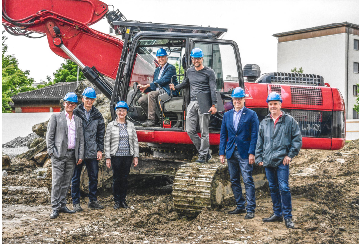
Am 6. Juni schritt die GBC zum Spatenstich für den Ergänzungsbau am Enikerweg. Von links nach rechts: Georges Helfenstein, Gemeindepräsident; Leonz Käppeli, Bauchef Vorstand GBC; Ruth Dössegger, Geschäftsleiterin GBC; am Schalthebel Josef Huwyler, Präsident GBC; Michel Tscherry, Archetage; Rolf Ineichen, Bauchef Gemeinde Cham; Arthur Sigg, Archetage.
