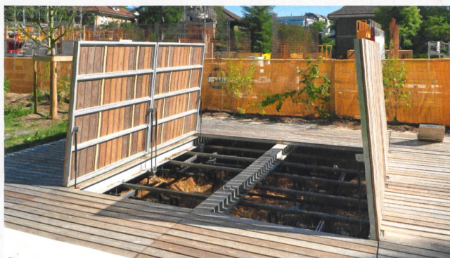
Im Garten befindet sich die siedlungseigene Kläranlage. Regenwürmer sorgen hier für die Endreinigung.
