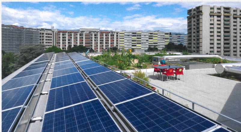
Den Strom, den die Photovoltaikanlage produziert, nutzt man selbst.
