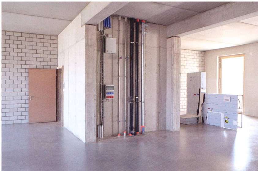
Die Künstlerinnen und Künstler übernehmen die Ateliers ohne jegliche Innenausstattung. Der Sanitär- und Küchenblock lässt sich frei bewegen und über einen Schlauch an der Decke an die Leitungsstränge anschliessen.
