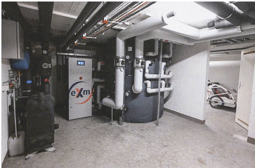
Blick in eine Energiezentrale mit Plattenwärmetauscher, Brauchwasser-Wärmepumpe und Warmwasserspeicher (von links). Nicht im Bild ist die Grundwasser-Wärmepumpe für die Raumwärme.
