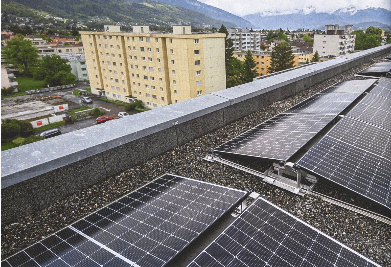
Kraftwerk mit Niesenblick: Die Dachflächen aller fünf Bestandesbauten der Siedlung Nüenen wurden mit PV-Anlagen ausgerüstet. Mit ihnen produziert die BWG Nüenen Solarstrom für den Eigenverbrauch.
