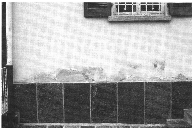
Fig. 2 Casa unifamigliare a Mosogno (Ti): tutti gli interventi eseguiti per frenare la risalita capillare hanno ottenuto il risultato opposto.
