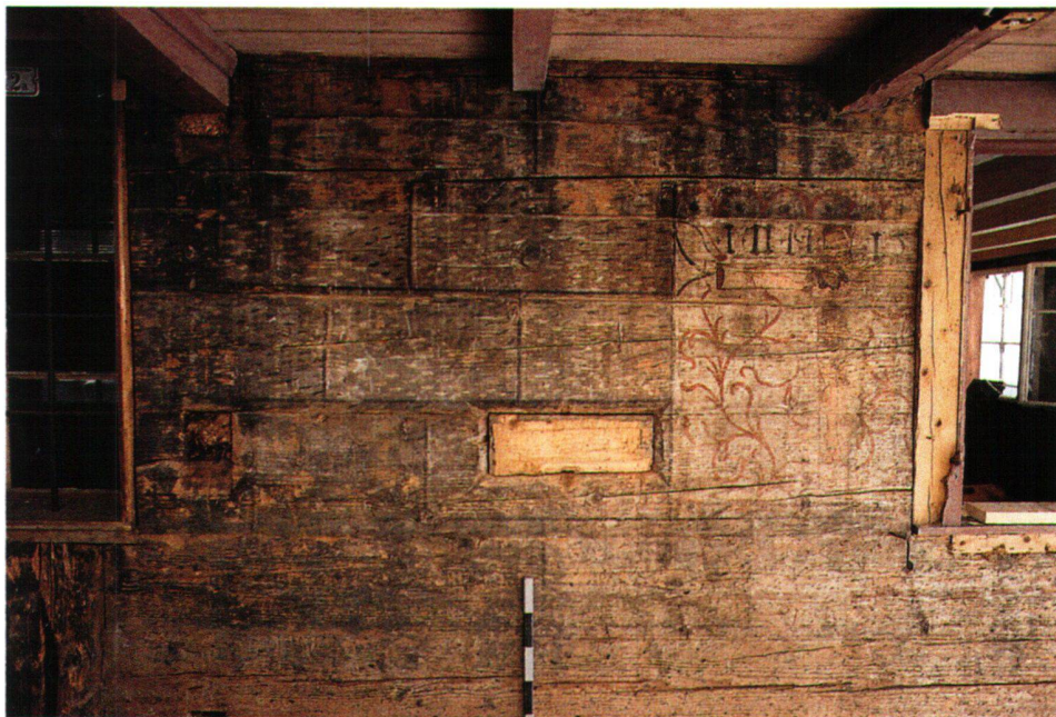
Abb. 16 Menzingen, Hauptstrasse 6: Quaderimitation und Kruzifixus an der Westfassade auf der Höhe des ersten Obergeschosses, Blick nach Osten. In der Mitte die originale Fensterluke.
