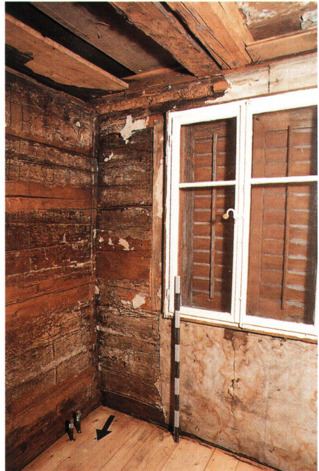
Abb. 12 Menzingen, Hauptstrasse 6: Die Südostecke der Stube im ersten Obergeschoss, Blick nach Südosten. An der Trennwand zur kleinen Kammer links Reste von Bemalung, insbesondere von Quaderimitation (unten). An der Südwand rechts abgesägte Deckenbretter (oben).
