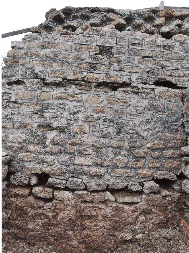
Abb. 7 Aventicum/Avenches (VD), théâtre romain. Aditus sud-ouest, mur M83, état après retrait de la végétation et dégagement de sa base, pierres profondément érodées, la première assise dégradée se trouvait au niveau du terrain, la seconde assise, entourée de ciment, a subi des dégâts dus au gel en raison de sa plus grande perméabilité, 2009.
