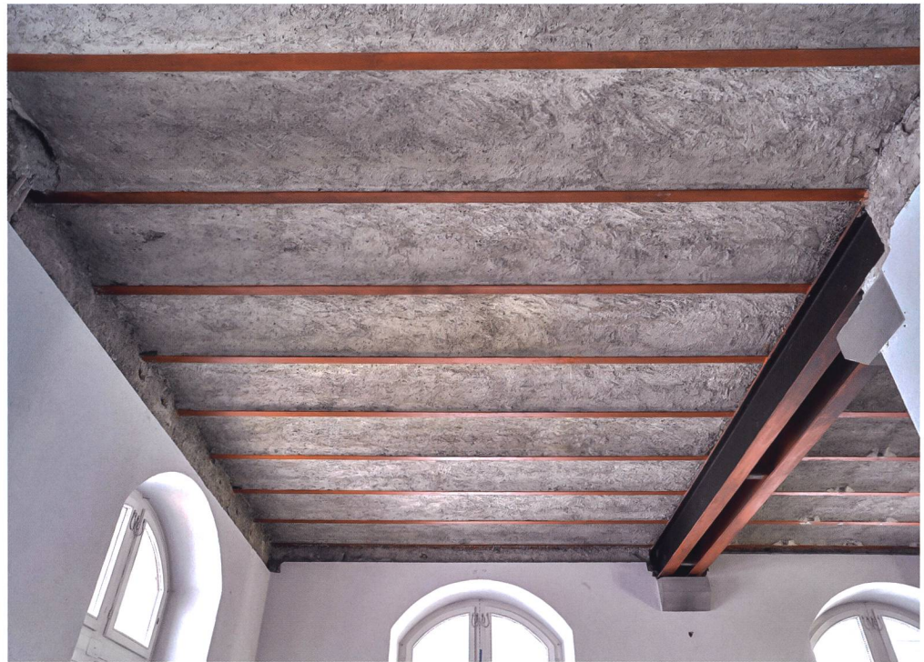
Abb. 28 Originale Betondecke mit Stahlträgern von 1898 nach dem Ausbau der Holzdecke aus dem Haus zur Goldenen Gilge, Zürich. Raum Korridor 00.102.H, Landesmuseum Zürich.
