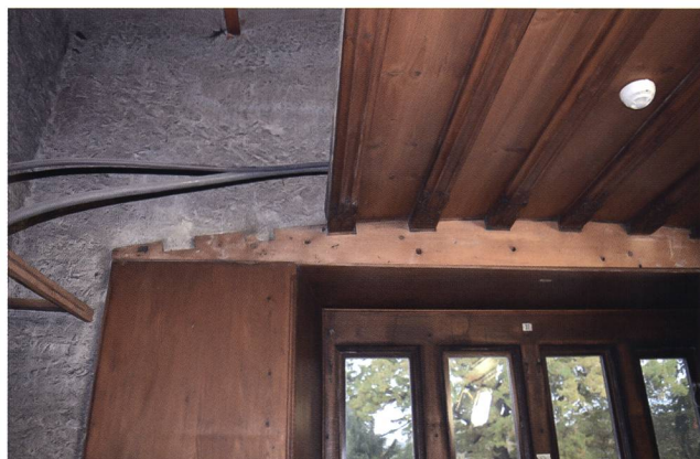
Abb. 18 Deckenbalken und -bretter liegen direkt in den Ausklinkungen der Unterkonstruktion. Helfenstein-Stube aus der Fraumünsterabtei in Zürich, Landesmuseum Zürich.
