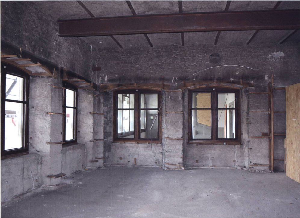
Abb. 30 Zimmer nach dem Ausbau der hölzernen Wandverkleidung und vor der Sanierung. Über und zwischen den Fenstern sowie in den Fensternischen ist die im Raum verbliebene Unterkonstruktion erkennbar. Amtsstube aus der Fraumünsterabtei Zürich, Landesmuseum Zürich.
