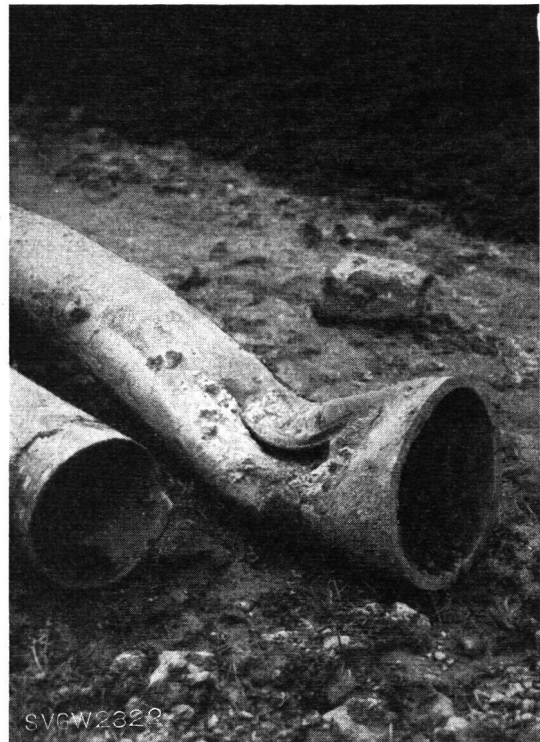
Abb. 6. Stokargässchen, Sprengbombeneinschlag. Mm.-Wasserrohr 250 mm Ø.
