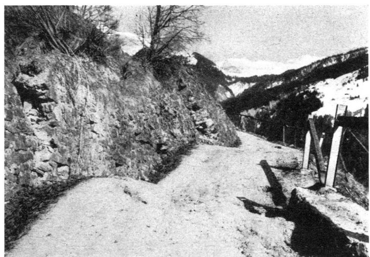
Strassenstück im Rutschgebiet
