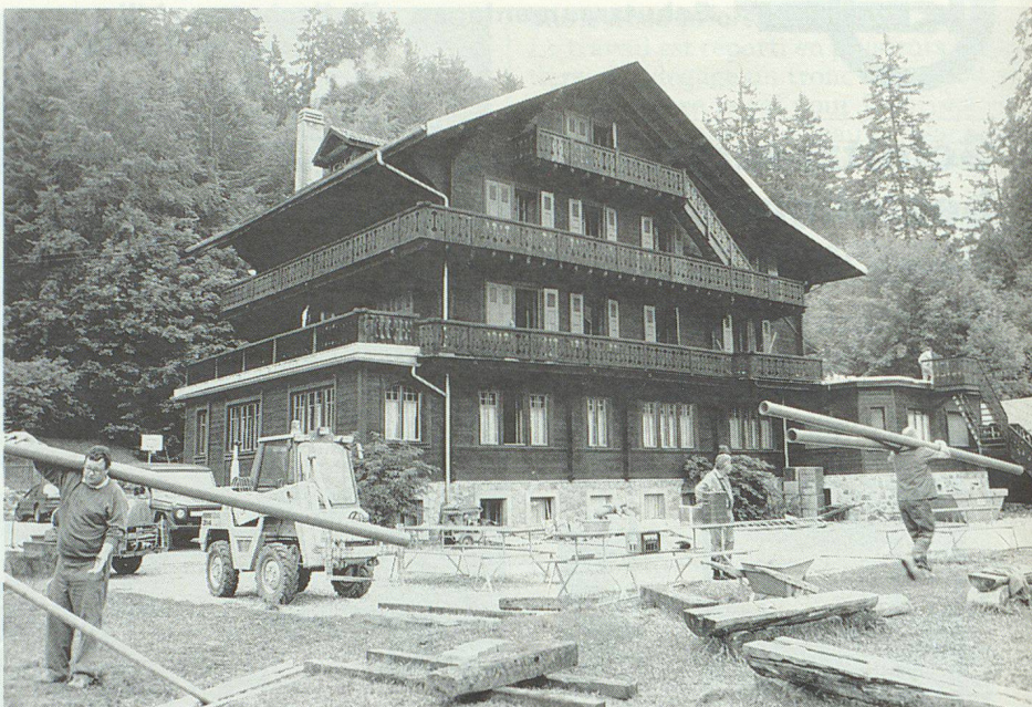
Le chalet «La Clairière», avec son escalier tout neuf; pour le reste, «ça draine, ça draine...».
