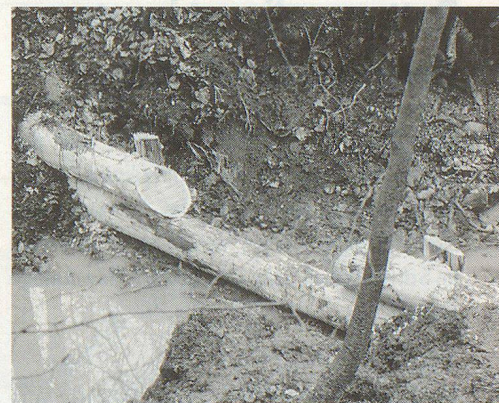
Eine der fachgerecht erstellten Bachverbauungen.
