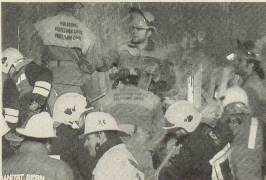
Bevölkerungsschutz: Feuerwehrleute, Sanitäter und Angehörige des Zivilschutzes suchen in den Trümmern eines eingestürzten Hauses in Bern nach Überlebenden oder Opfern.
