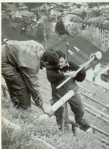
Solide Sicherungen im steilen Hanggebiet oberhalb des Dorfes.
