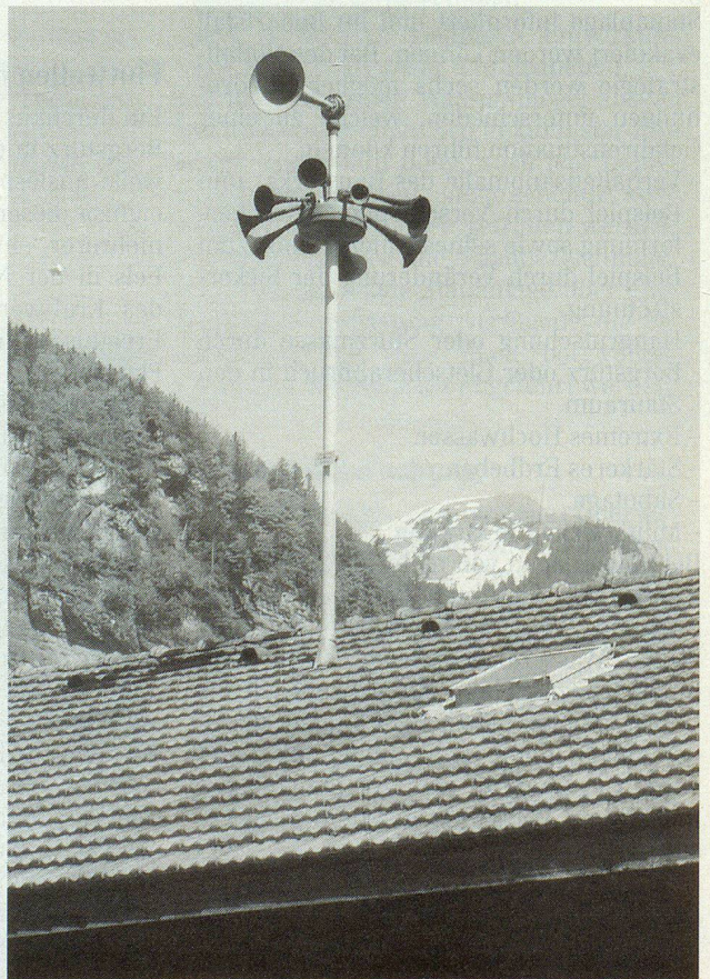
Meiringen: Wasseralarm- und Feueralarmsirenen auf einem Dach.
