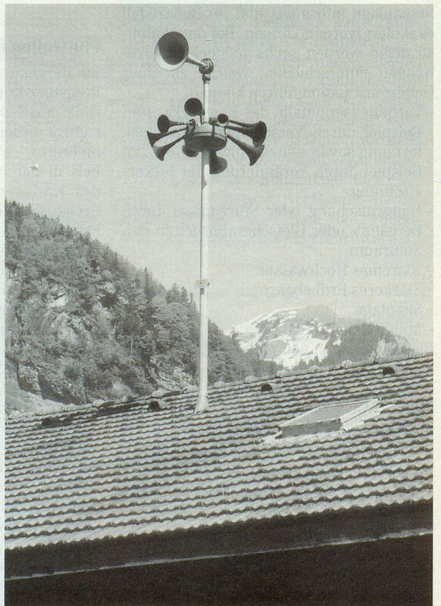
Meiringen: Wasseralarm- und Feuerwarnsirenen auf einem Dach.
