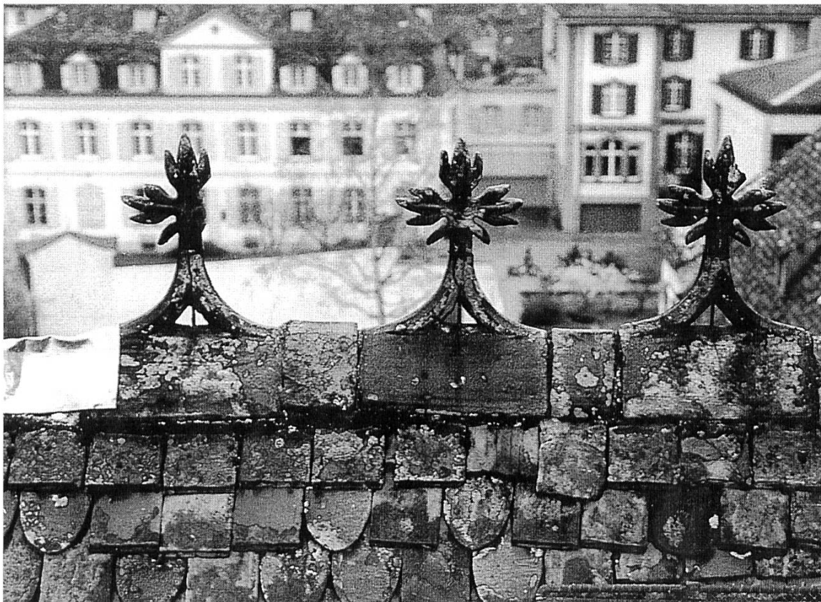
Abb. 5 Niklaus- kapelle: Alte Firstziegel vor der Renovation.
