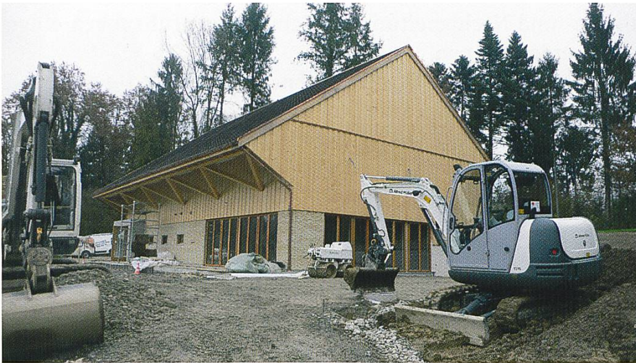
Cham, Zieglerareal: Museumsneubau während des Innenausbaus und der Umgebungsarbeiten, Blick gegen Norden (14.11.2012).
