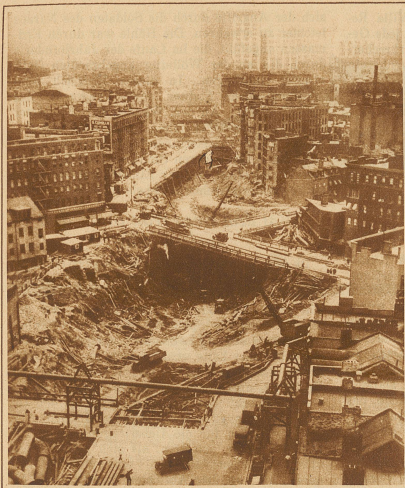
Auch New York reißt seine Straßen auf. Das Bild zeigt einen anschaulichen Blick in die Baugruben einer neuen Untergrundbahn, die mitten in der City New Yorks längs der 6. Avenue gebaut wird
