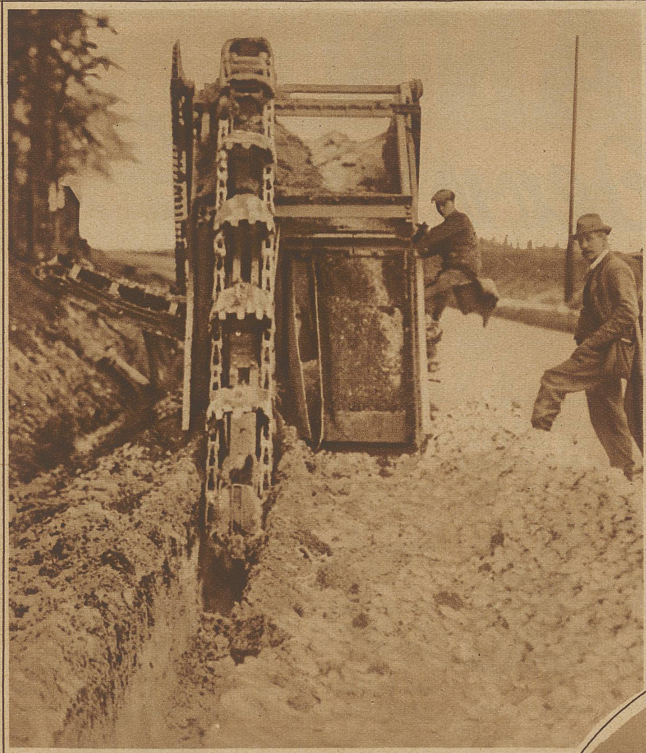
Eine neuartige Grabenmaschine, die in einer Stunde die gleiche Arbeit verrichtet, wie 50 Mann im Tag. Die Maschine wirft 40 cm breite und bis 1,20 Meter tiefe Gräben aus
