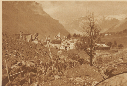
Blick von der Gefahrenzone gegen Lintthal talwärts. An der Erstellung eines Scherwalles im Vordergrund wird mit Wägen überhört gearbeitet.
