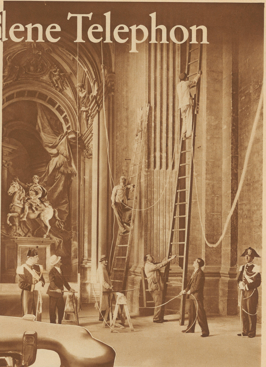
Aufhängen des Kabels im Atrio Carlomagno, der Verbindungshalle zwischen Vatikan und Peterskirche
