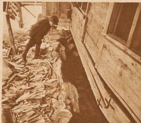
Der Boden rutscht unter dem Haus weg und bringt den Keller ans Tageslicht
