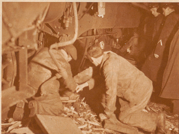
Schwierige Schweißarbeit an der schwerbeschädigten Lokomotive des Zürcher Zuges. Die Verschachtelung der Lokomotiven und der einzelnen Wagen war so stark, daß man sie mit Schweißapparaten angehen mußte, um sie voneinander zu trennen und ins Innere einzudringen
